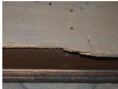
Abb.36: Ausgebrochene Kante einer Kniebank
