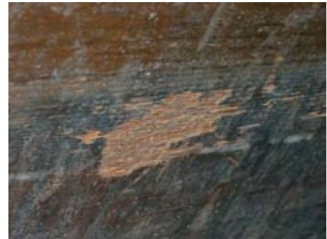
Abb.30: Fraßgänge an der Innenfläche einer Brüstung
