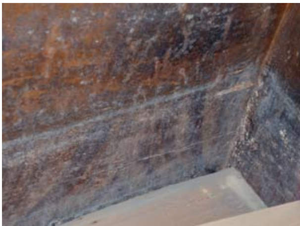
Abb.41: Abgeriebene und verschmutzte Bereiche hinter der Kniebank
