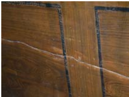
Abb.35: Riss quer durch eine Brüstungsfront
