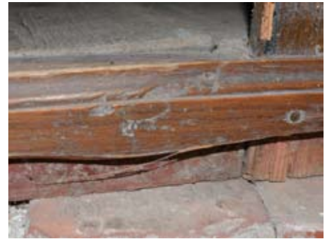
Abb.25: Abgesplitterte, sekundäre Sockelleiste
