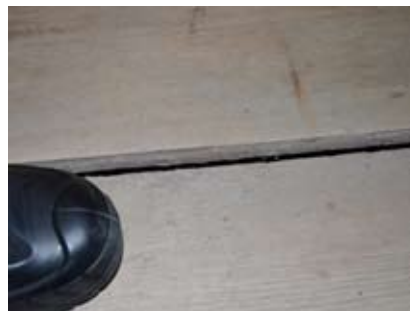
Abb.28: Durchbiegen der Diele beim Betreten
